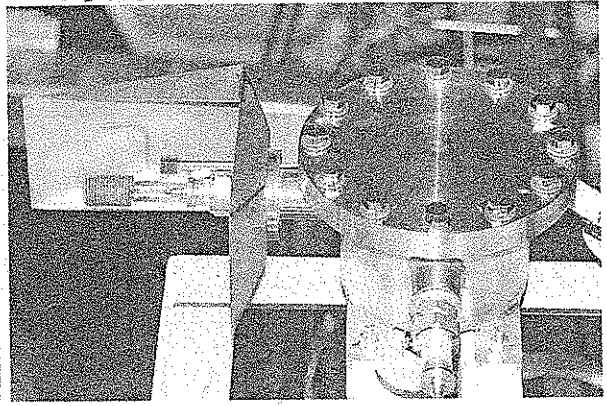
水素爆発を防ぐための「水素燃焼装置(イグナイタ)」 =いずれも10日午前、高浜町の関西電力高浜原発で
